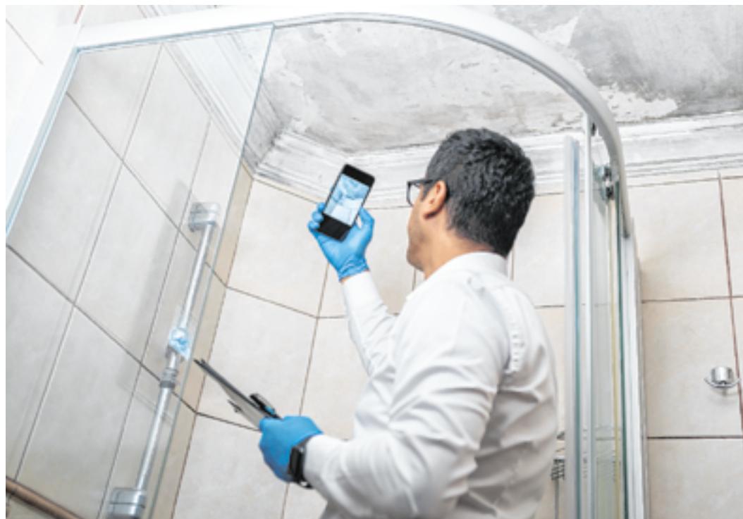
Der typische Streitfall ist Schimmelbildung: Drohen gesundheitliche Probleme, dann ist eine Mietzinsminderung in einem bestimmten Ausmaß gerechtfertigt. Foto: iStock
